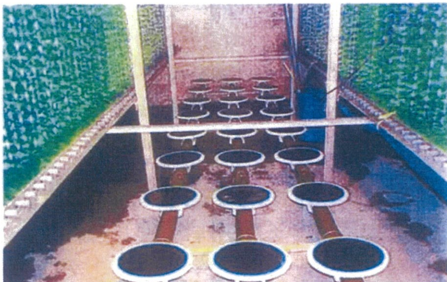
・沈殿槽(SMS法改良後)
